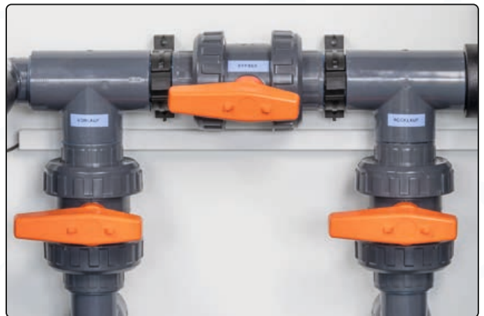
Bypass öffnen / Vor- und Rücklauf schließen
