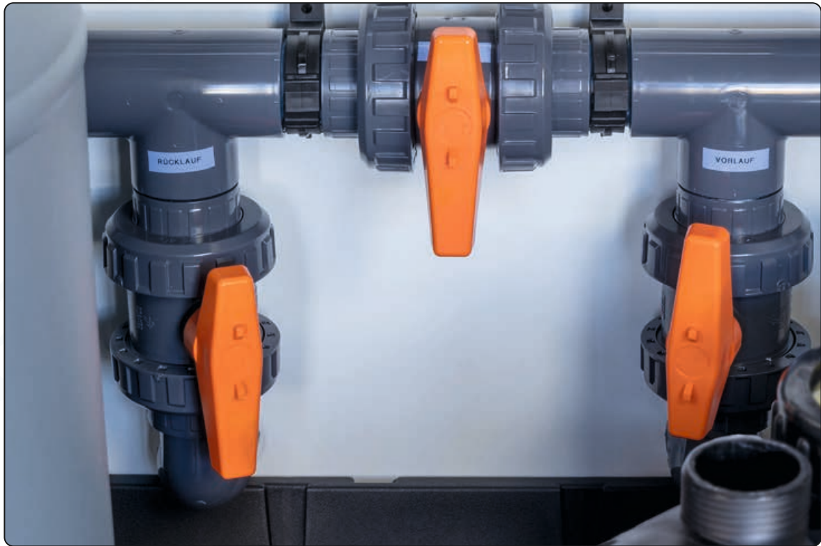
Heizungsbypass geschlossen / Vor- und Rücklauf geöffnet
